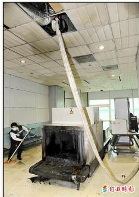
桃園機場第二航廈C1候機室旁的X光機，昨日清晨突然起火冒煙，所幸火勢並未延燒，X光機遭燒毀。(記者朱沛雄攝)
